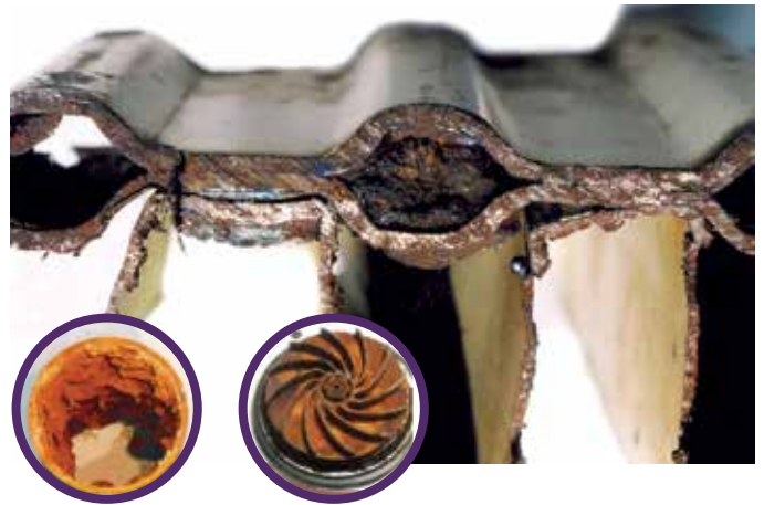
Поврежденные компоненты установки из-за загрязнения воды
